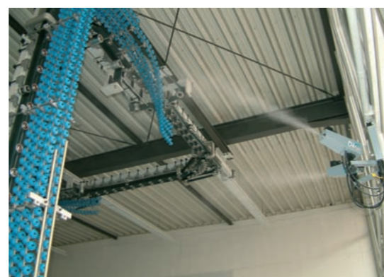
Quatre systèmes à gicleurs haute pression du type DRAABE DI Puls sont installés à Augsburg depuis maintenant 10 ans.
