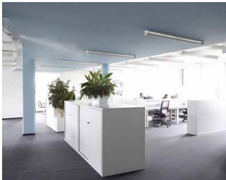
Humidifier dans les bureaux
