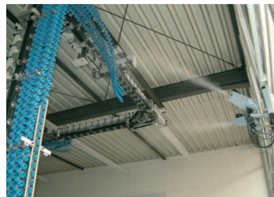
Quatre systèmes à gicleurs haute pression du type DRAABE DI Puls sont installés à Augsburg depuis maintenant 10 ans.
